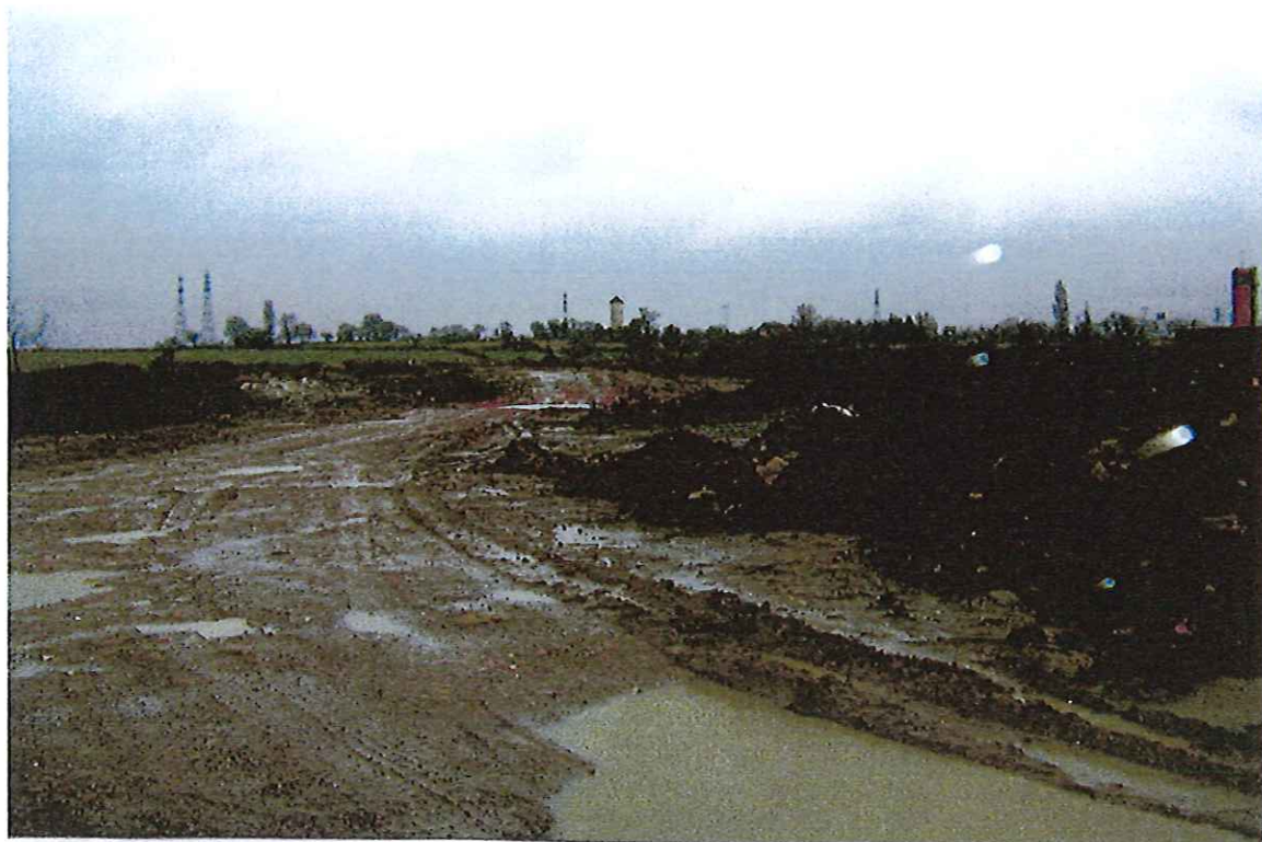
CLICHE N°1 : Vue du nouveau site en cours d'aménagement depuis le côté ouest (à gauche, on distingue le site du SDIS par sa tour rouge).
