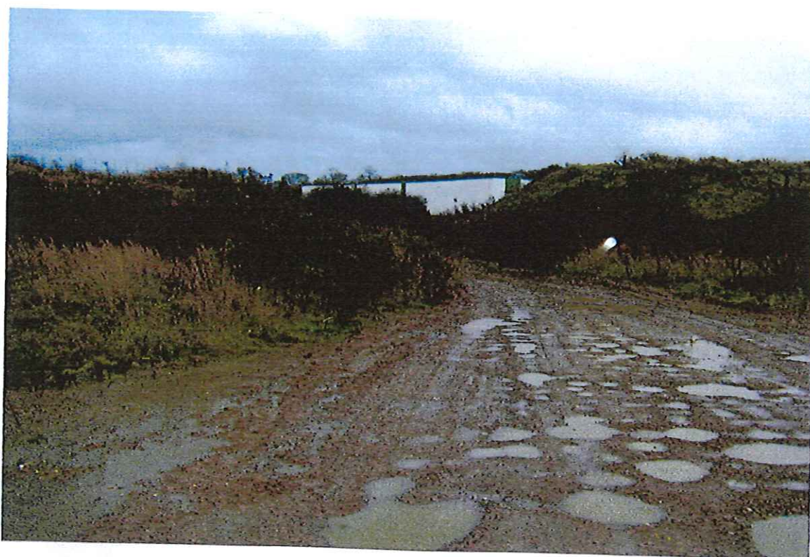
CLICHE N°3 : Voie d'accès sur le site projeté en cours de remblaiement.
