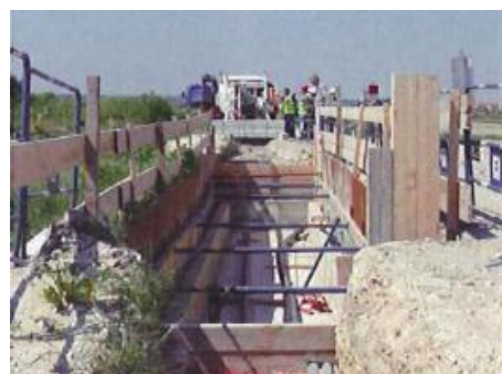
Chambre de jonction
