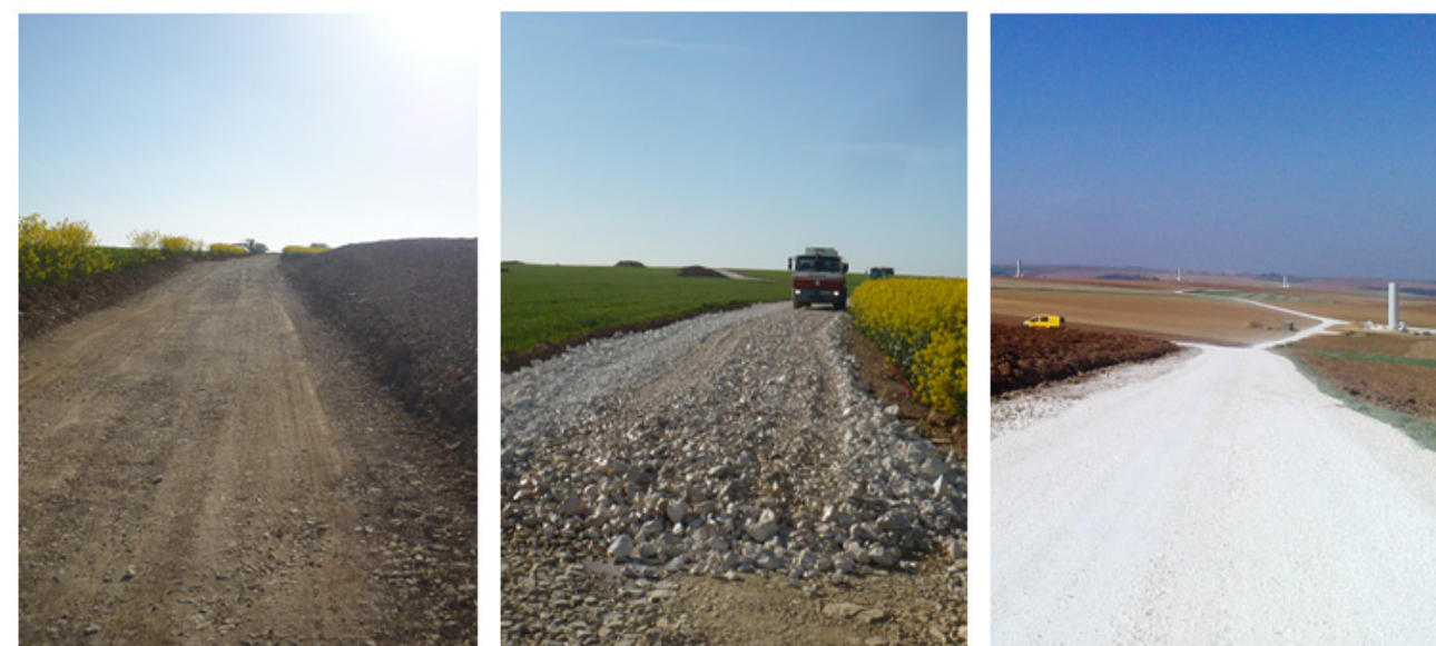
Opération de décapage ; mise en place de la couche de fond de forme ; mise en place de la couche de finition
