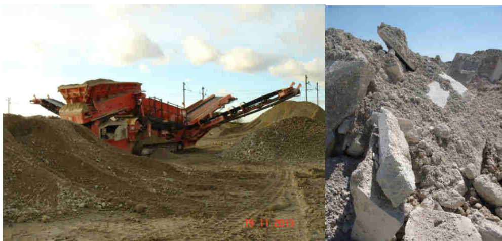
Figure 3 : Chantier de concassage de matériaux de déconstruction sur le site EQIOM du Plessis-Belleville (60)
