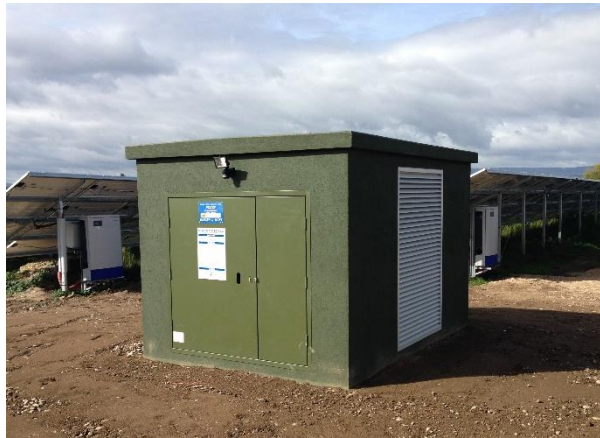
Exemple de poste de transformation sur un parc solaire – Source : Luxel, 2017
